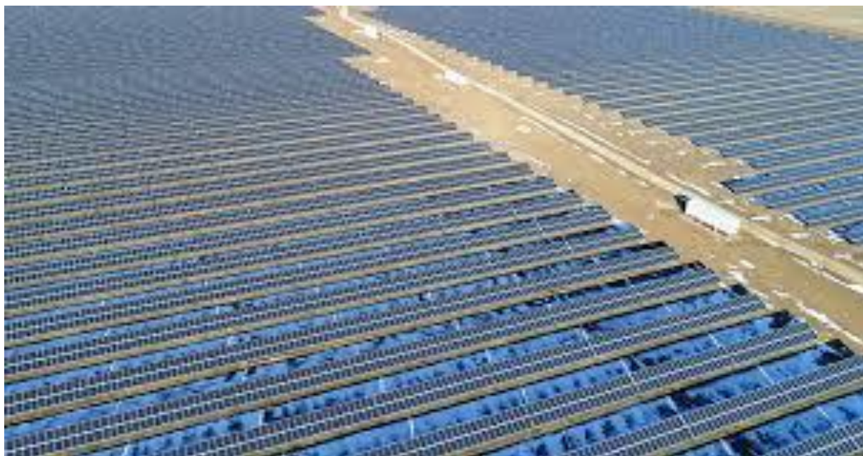
7.6-rasm. Quyosh elektr stansiyasi
